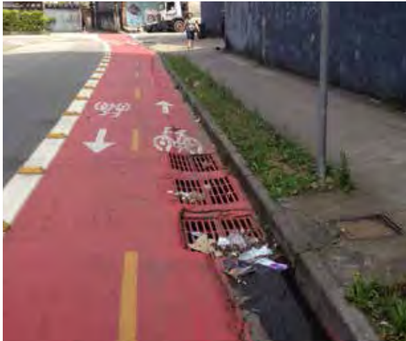
Grelhas inadequadas, com aberturas longitudinais, no mesmo sentido da circulação R. Cel. Mario de Azevedo, Zona Norte
