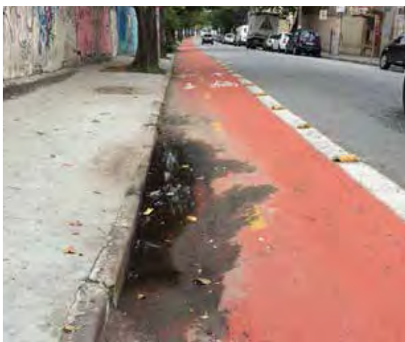
Sarjeta com buracos e água em área útil da ciclofaixa Rua da Várzea, Zona Norte
