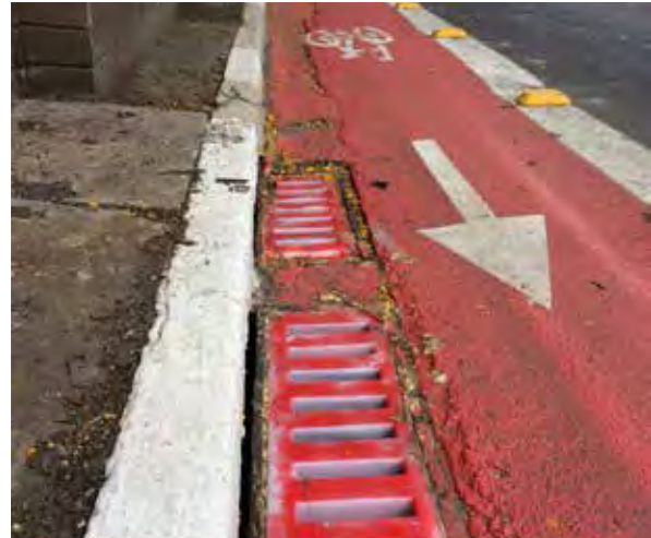
Grelhas adequadas, com aberturas perpendiculares ao sentido de circulação R. da Consolação, Centro
