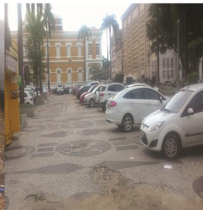
Praça da República - Estacionamentos irregulares que causam a destruição do pavimento
