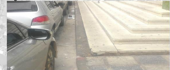
2. Inexistência de calçada devido ao avanço das escadas. Foram demarcados locais onde há a inexistência de calçadas, dificultando a circulação de pedestres. Como exemplo, a Entrada da Igreja Matriz, situada na Rua Antônio Maria, esquina com a Av. Getúlio Vargas
