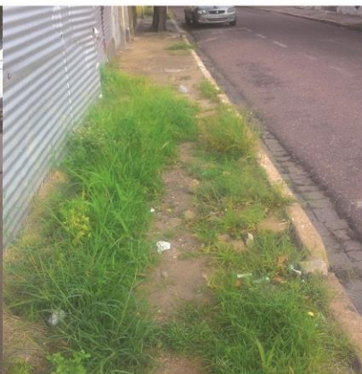
Rua 24 de Outubro - Vegetação sem manutenção em um pavimento degradado.
