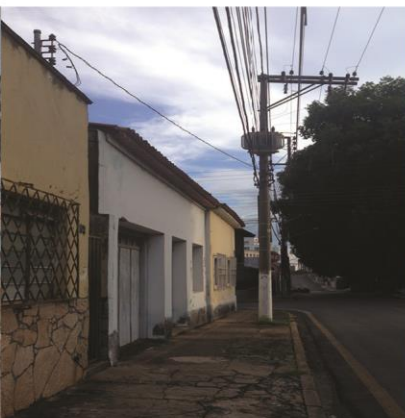
Rua Batista das Neves - Fissuras e trinças profundas na calçada. Foto: Gabriela Guedes
