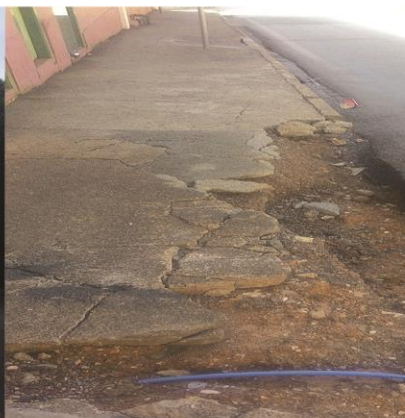
Rua Voluntários da Pátria - Más condições da pavimentação das calçadas
