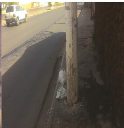
Av. Tenente Coronel Duarte - Presença de obstáculo na via, impedindo a passagem segura do pedestre
