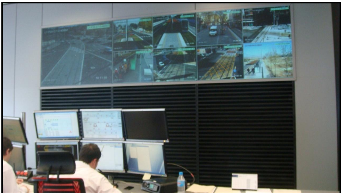
Figura 4.4.1 - Vista parcial do CCO
